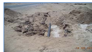
Múltiples filtraciones Sector Aducción Ruta A-616.
