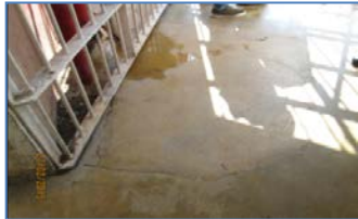
Filtración de Red Húmeda en módulo 41 a 44.
